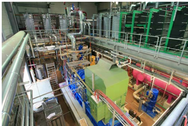
Kalina-Anlage mit Generator (grün) und Ammoniak-Tank (rosa)
