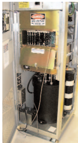
Foto: MVV Energie
